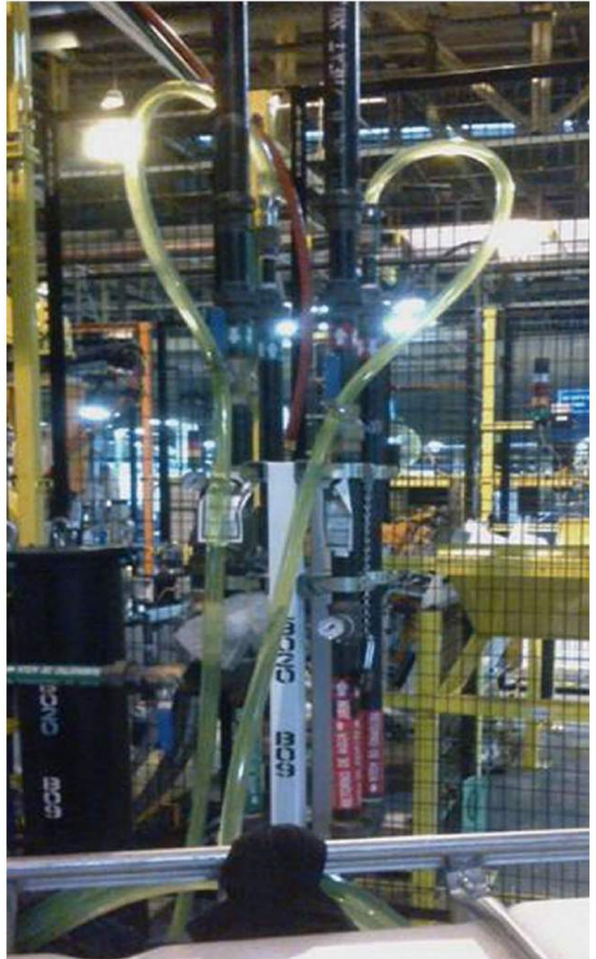
Sistema de recirculación de solución alcalina
